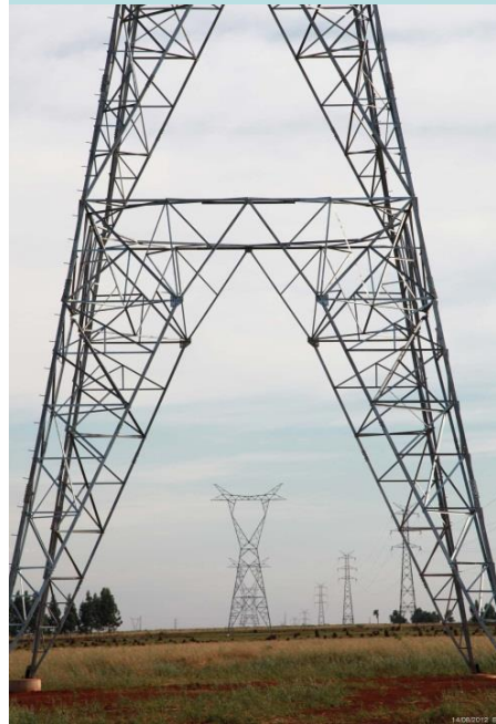
Linha de Transmissão em 500 kV de 350 km
