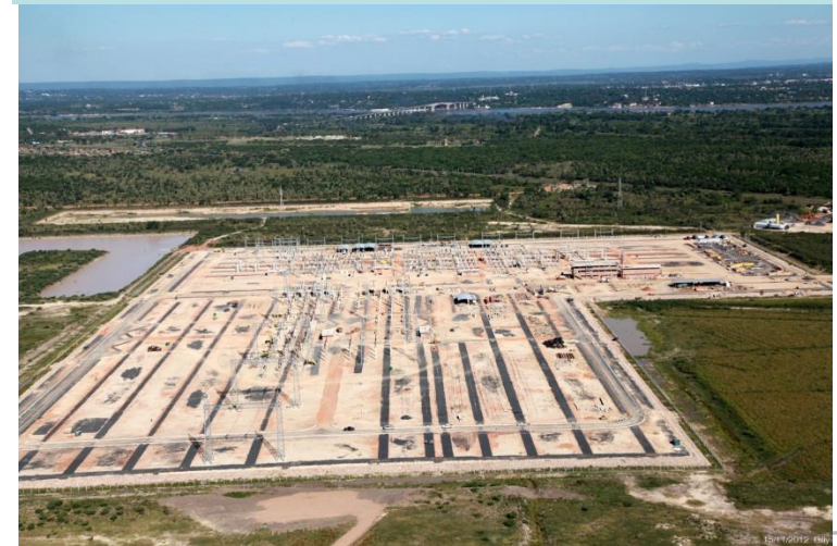
Subestação completa de 500 kV em Assunção
